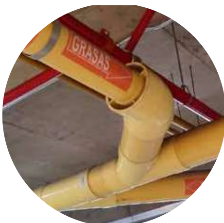
Sistema en PVC sanitario y ventilación
