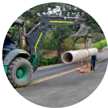
Sistema de acueducto
