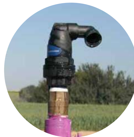
Válvulas de aire ventosas
