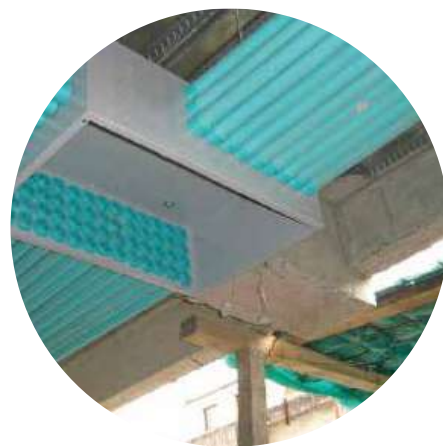
Sistema eléctrico conduit PVC
